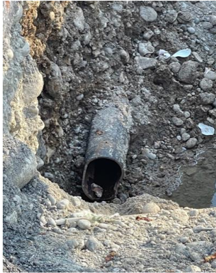
Freigelegtes veraltetes Rohr
