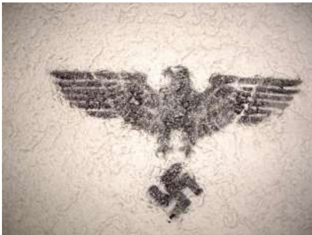
Sprayerei an der Fassade des Schulhauses
