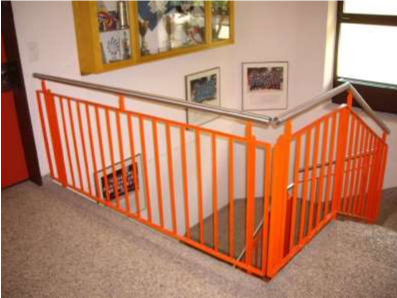
Treppengeländer MZH nach neuer Sicherheitsvorschrift
